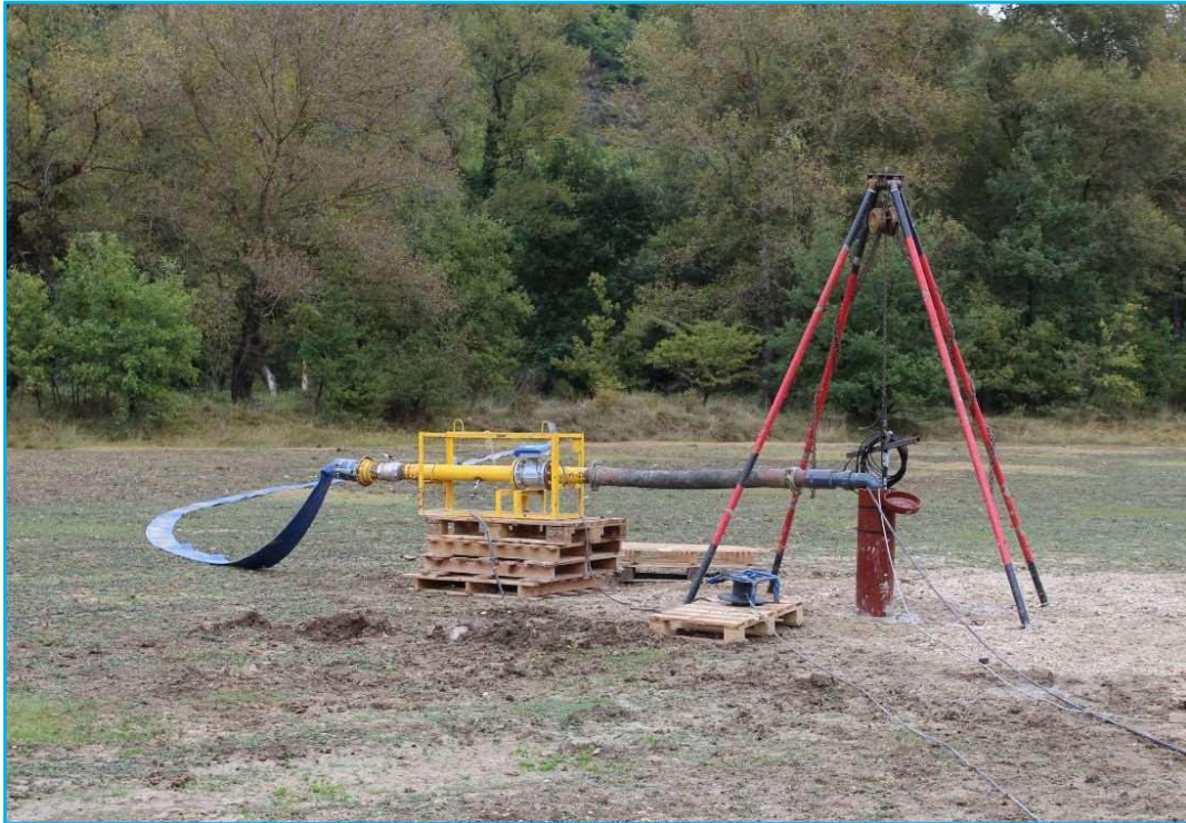
Figure 13 : atelier de pompage - octobre 2018
